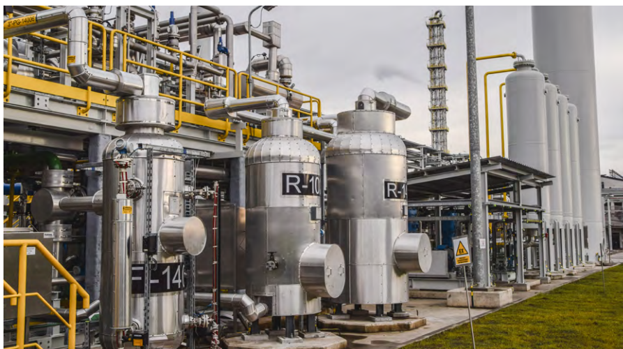
Część nowej instalacji w trzebińskiej rafinerii
