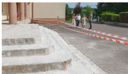
Schody prowadzące do szkoły w Dulowej pilnie wymagały remontu
